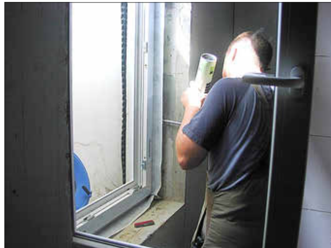
Montageschaum reicht beim Einbau neuer Fenster nicht aus – der Rahmen muss luftdicht in der Leibung verklebt werden. Foto: VZ RLP
