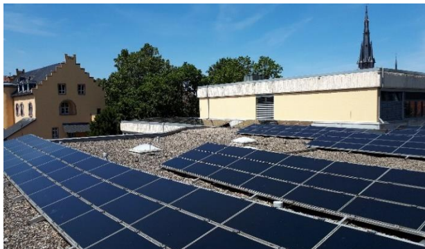
Bild: PV-Anlage GS Schloss Ardeck (Quelle: Bau-Abteilung VG Gau-Algesheim)
