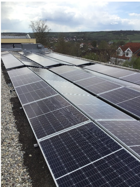
Bild: Die neue PV-Anlage (Quelle VG Gau-Algesheim)
