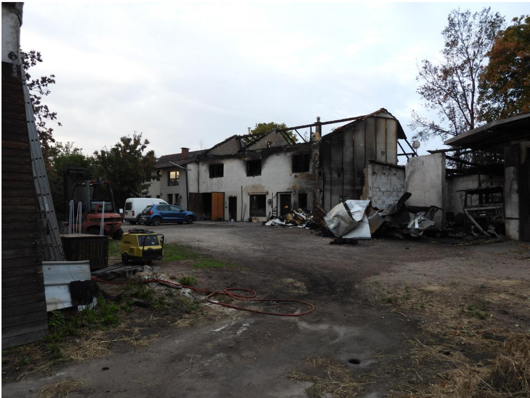
Bild 14: Das Wohnhaus ist vollständig ausgebrannt
