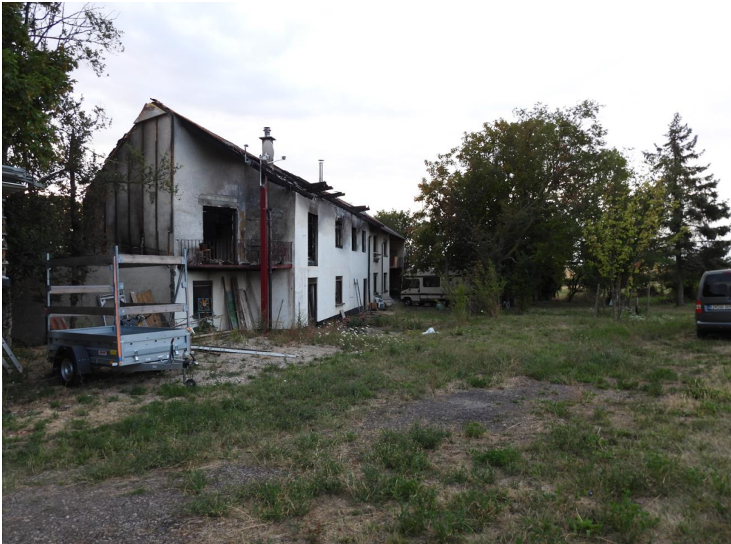
Bild 13: Blick auf das ausgebrannte Wohnhaus im Süden von Teilgeltungsbereich C
