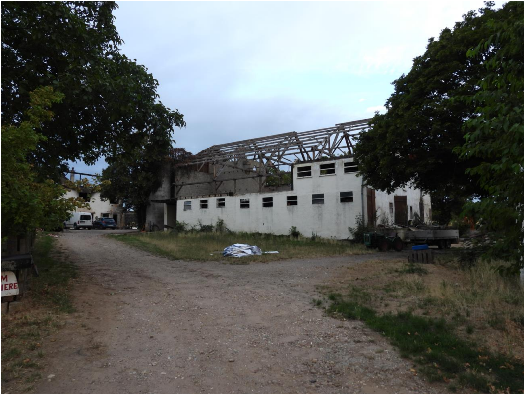
Bild 17: Südansicht der Scheune, die durch das fehlende Dach keine Eignung für Fledermäuse oder Eulenvögel besitzt
