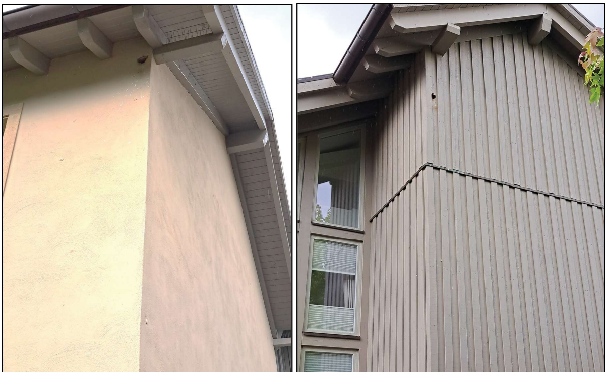
Abb. 15: Spechtlöcher in der Außenfassade der Bestandsgebäude (IBU, 2024)
