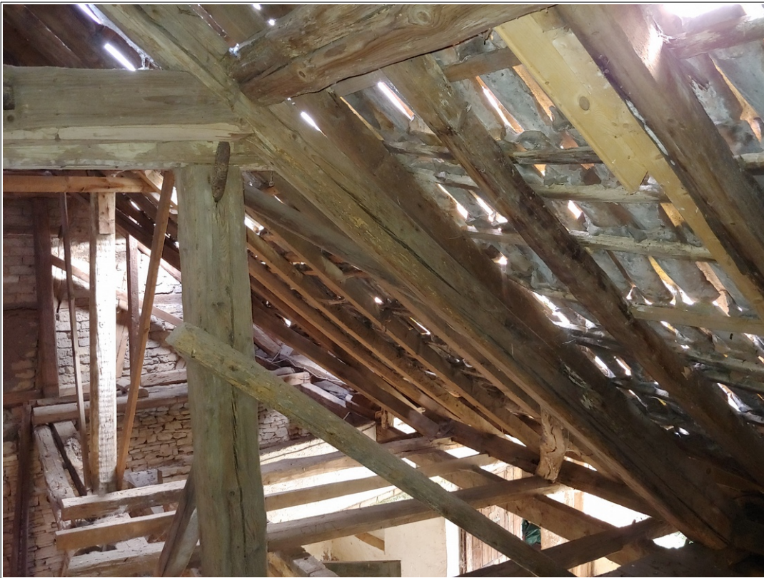
Fotostandort 2: Scheune wird abgerissen, sehr offene Dachstruktur, einsturzgefährdet
