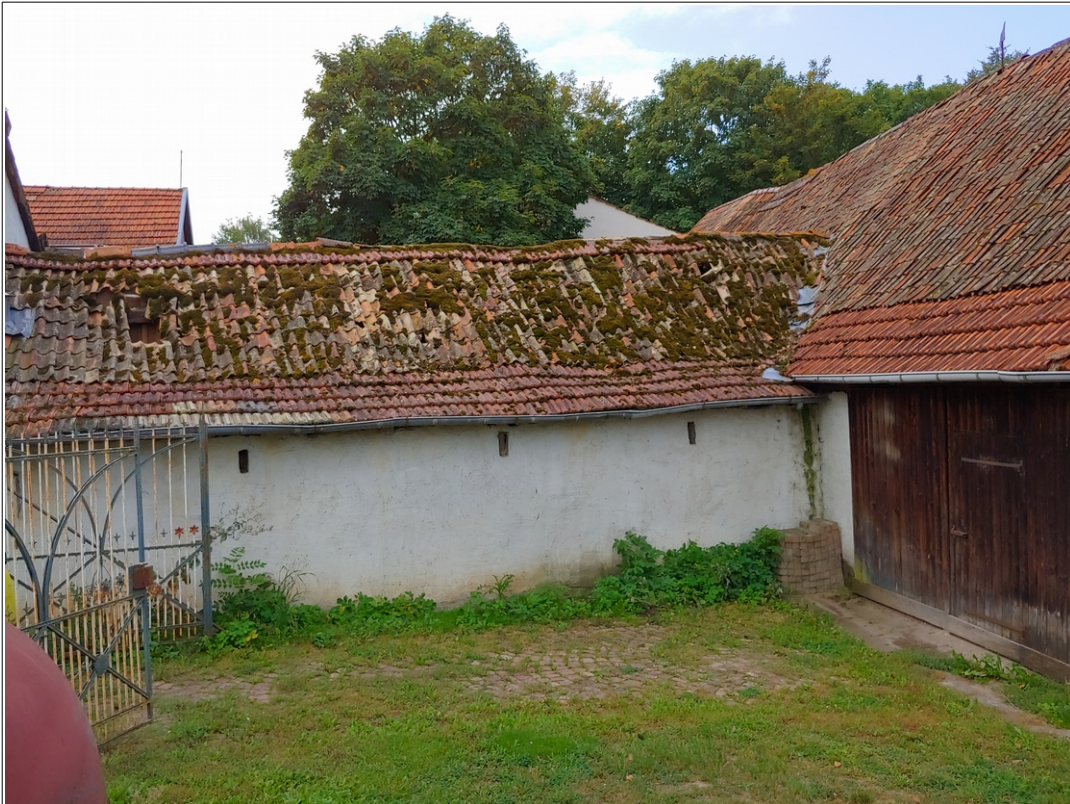
Fotostandort 3: Dach wird saniert, sehr offene Dachstruktur, einsturzgefährdet
