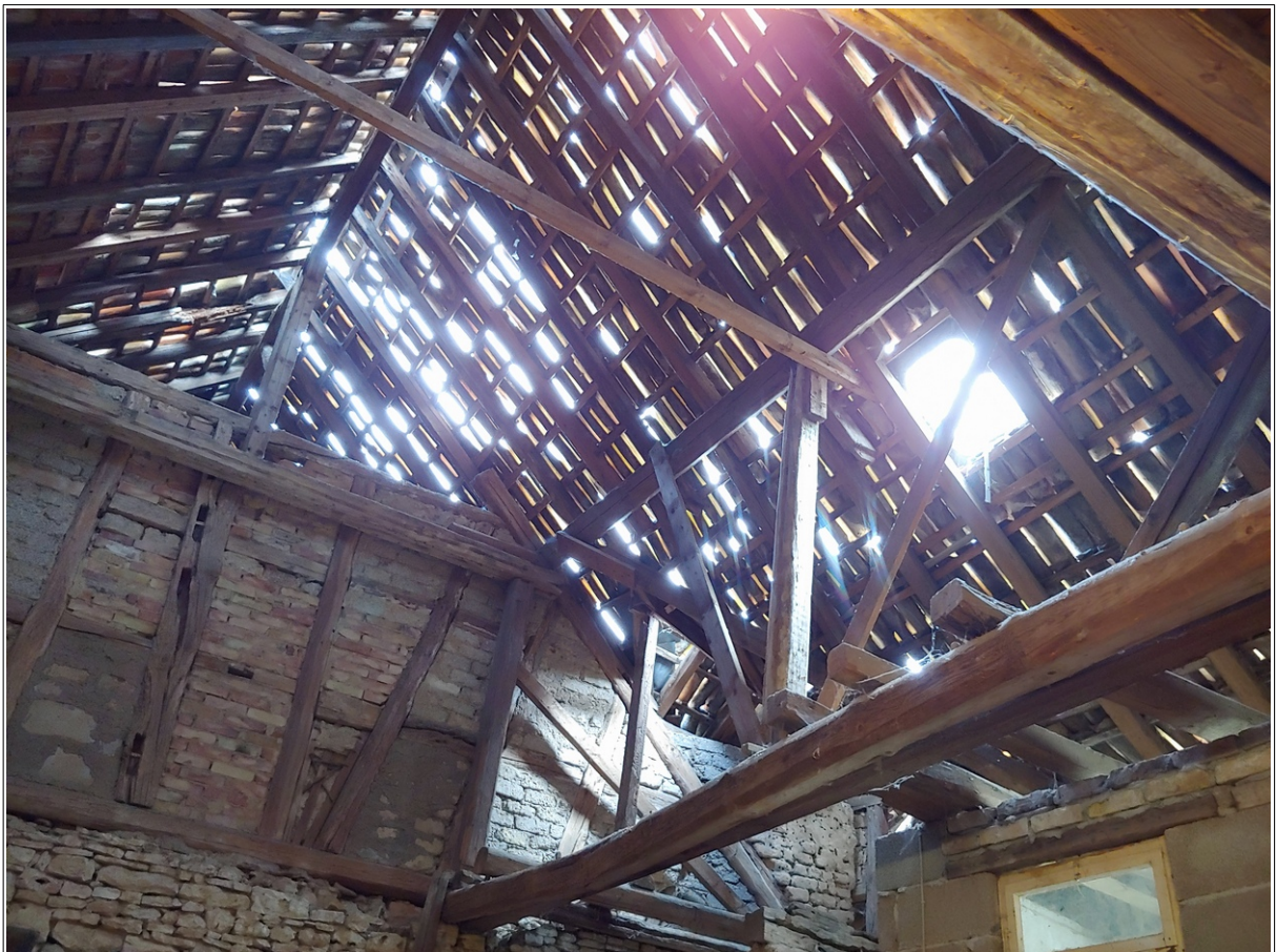
Fotostandort 1: Scheune wird abgerissen, sehr offene Dachstruktur, einsturzgefährdet
