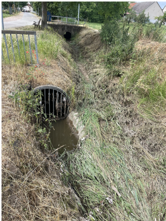
Abbildung 1: Entlastungsleitung des RÜ in den Wethbach (Brunnengasse)
