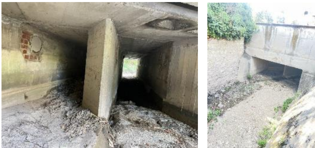
Abbildung 16: Ablagerungen im Durchlass Bahnhofstraße
