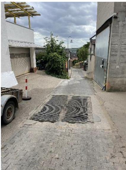
Abbildung 15: Gitterschacht in der Wackenheimerstraße
