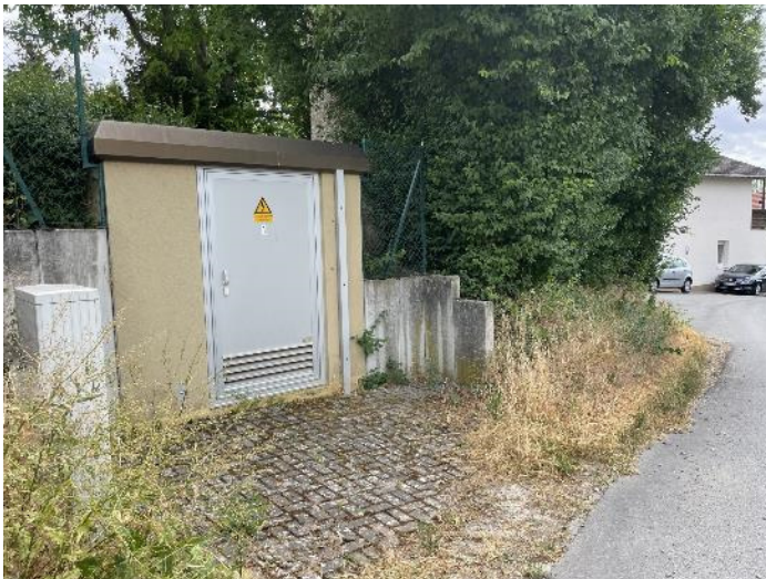
Abbildung 3: Stromverteiler im Gefährdungsbereich
