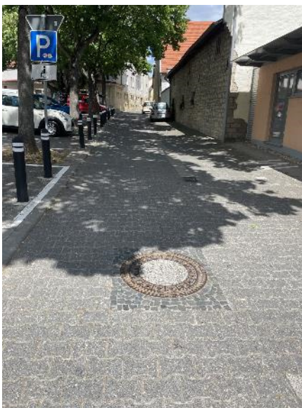
Abbildung 1: Kanaldeckel des Staukanals in der Bachstraße
