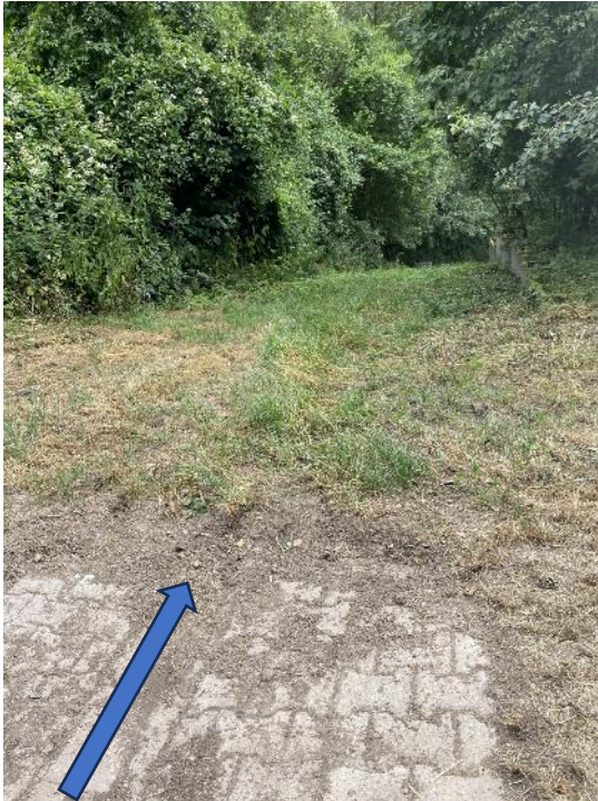
Abbildung 10: Starker Bewuchs in Abflussrinne
